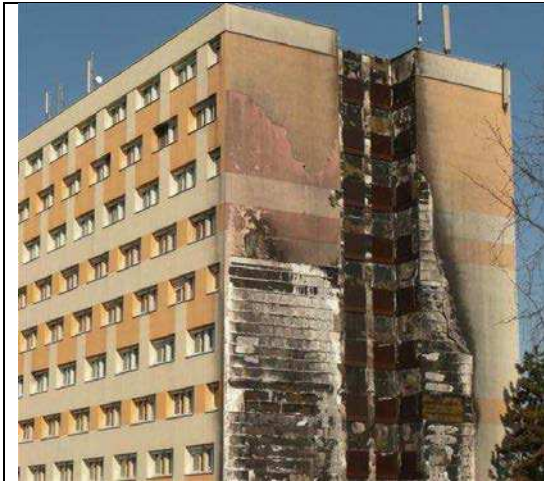
Figure 3 : État de la façade après l'incendie
